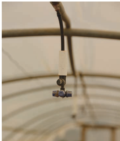
Σύστημα δροσισμού με μικροεκτοξευτήρες νερού
